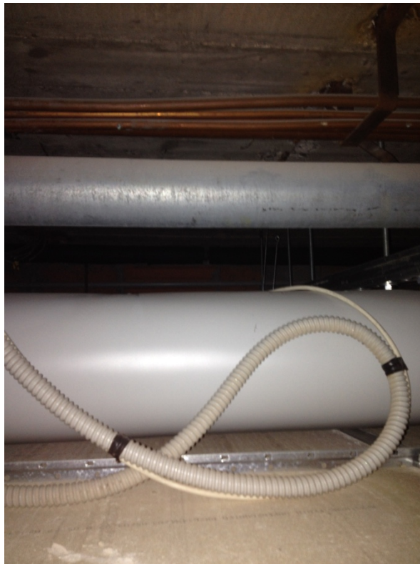
FOTO 14 Dorsali acqua per CTA (a filo controsoffitto) e tubazioni gas medicinali
