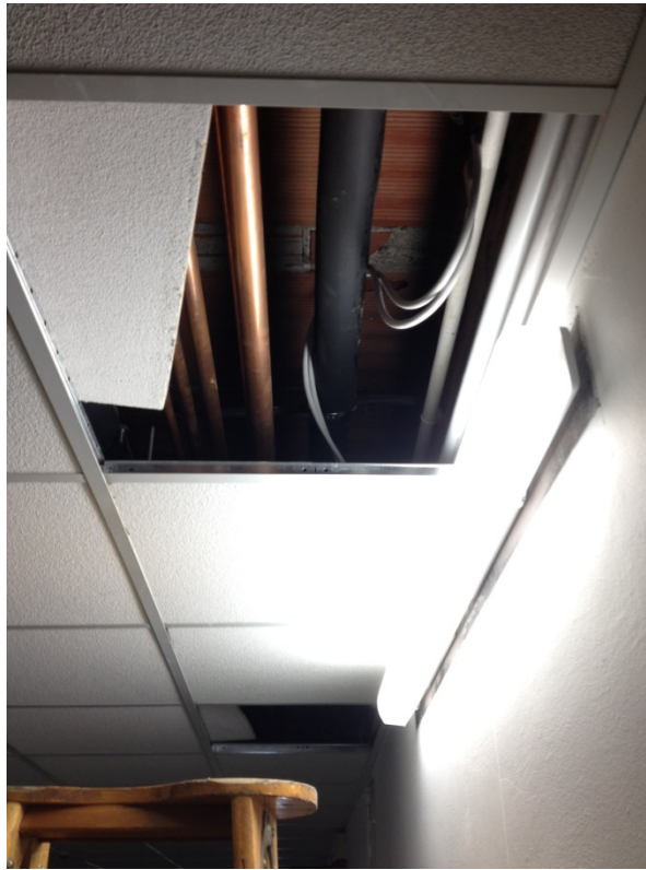
FOTO 17 Tubazioni gas medicinali
